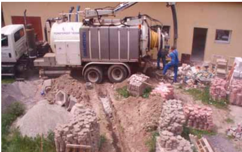
Pred dokončením. Rekonštrukcia knižnice a ďalších zariadení je pred dokončením. Budova je napojená na všetky inžinierske siete. Otázkou sú však tak často skloňované financie
